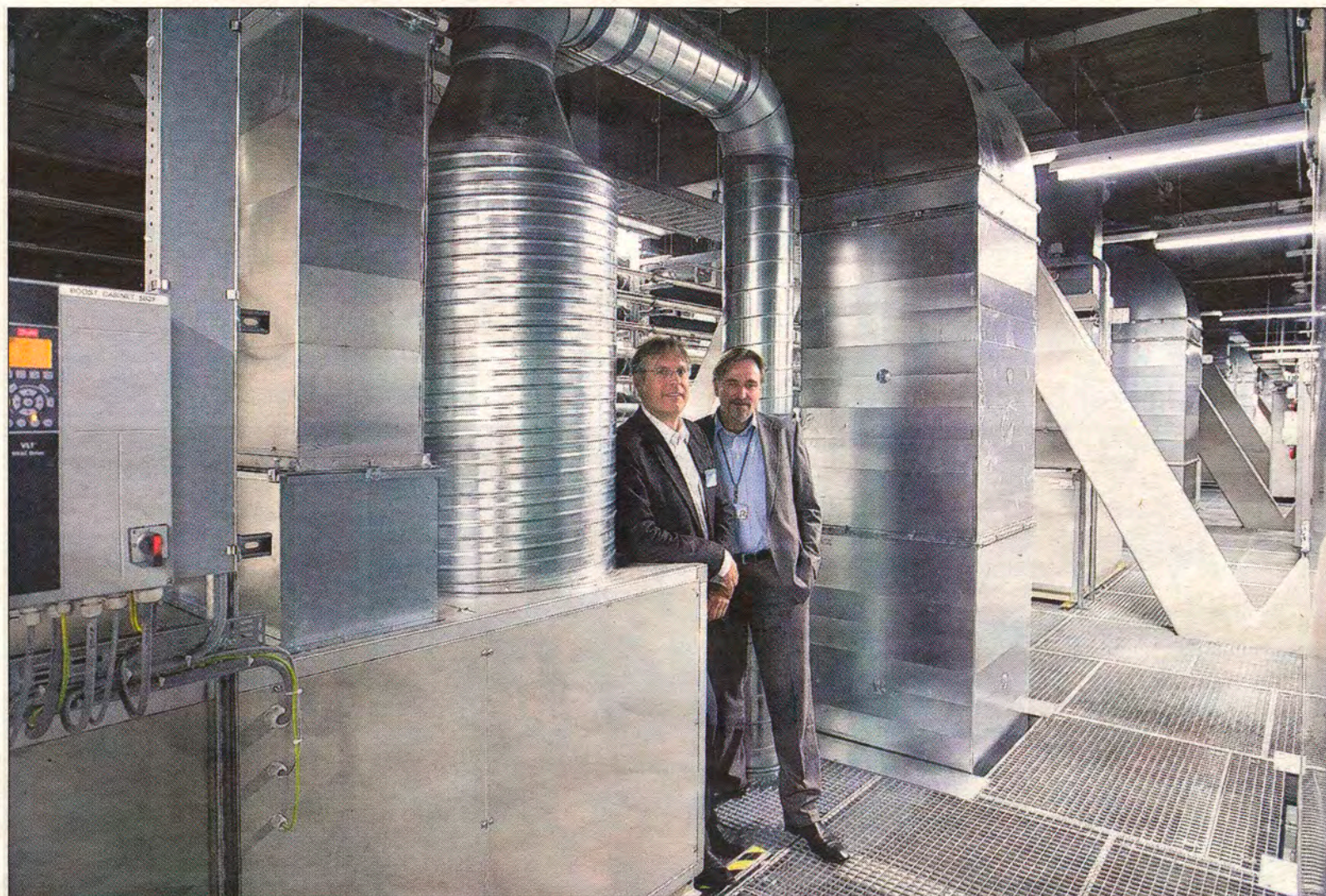
Architect Rik van der Velden (l) en Theo Bartraij, directeur Fabrieken van ASML, in de technische ruimte boven de cleanrooms.
